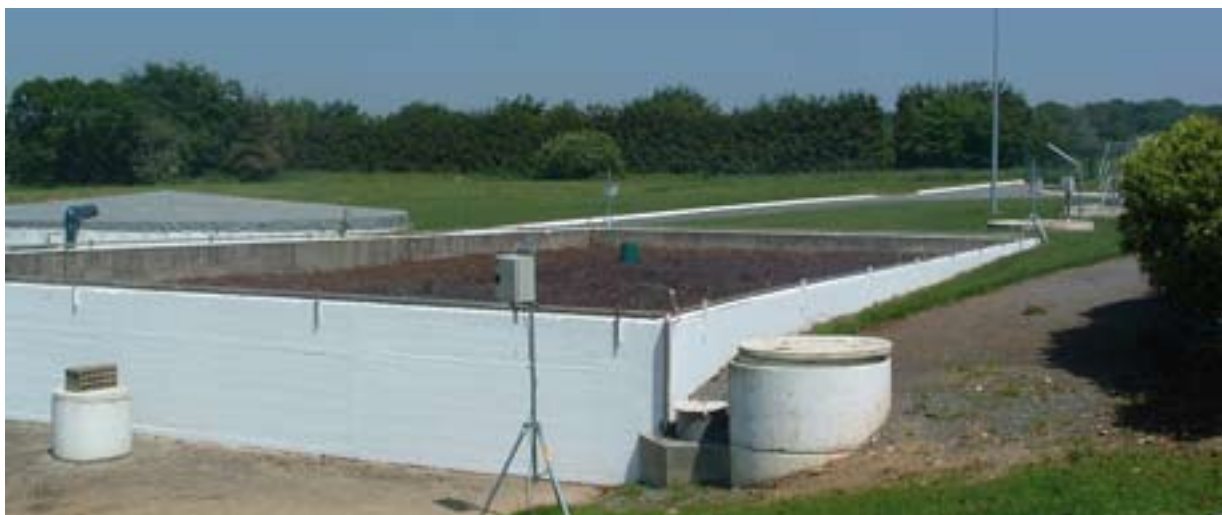
À Plouvara, un nez électronique surveille en continu les odeurs émises par le biofiltre.
